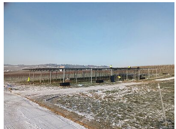
Montage der PV-Module auf der Agri-PV Anlage im Dezember 2022. @Dennis Jouaux, Hochschule Geisenheim
